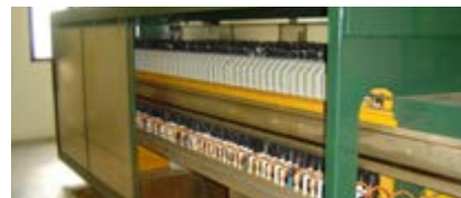
Tratamento de Lamas (5m³/h)
