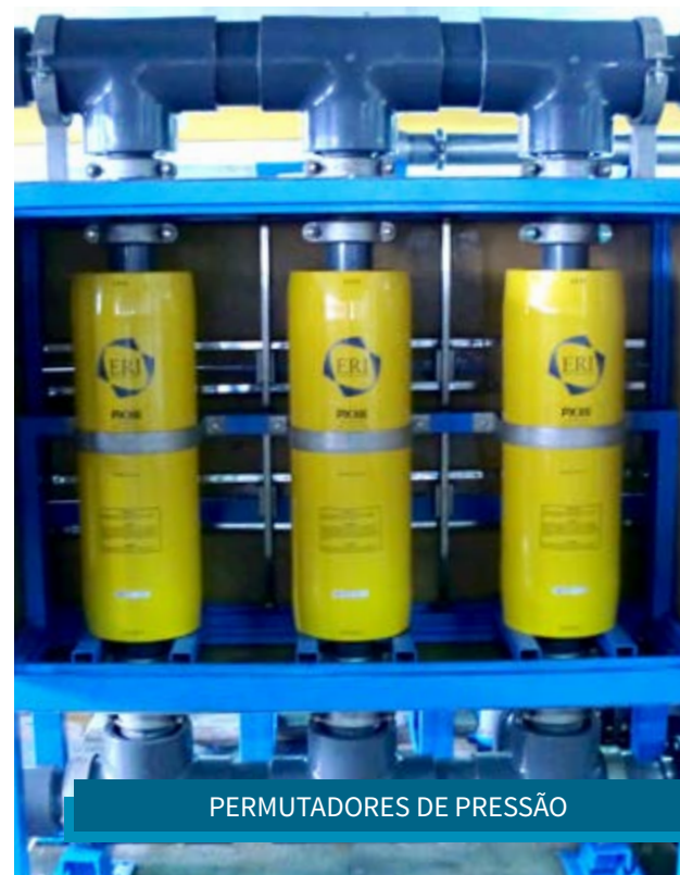
GALERIAS TÉCNICAS E DE BOMBAGEM PRIMÁRIA
