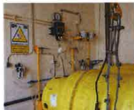
22 Estações de Cloragem
