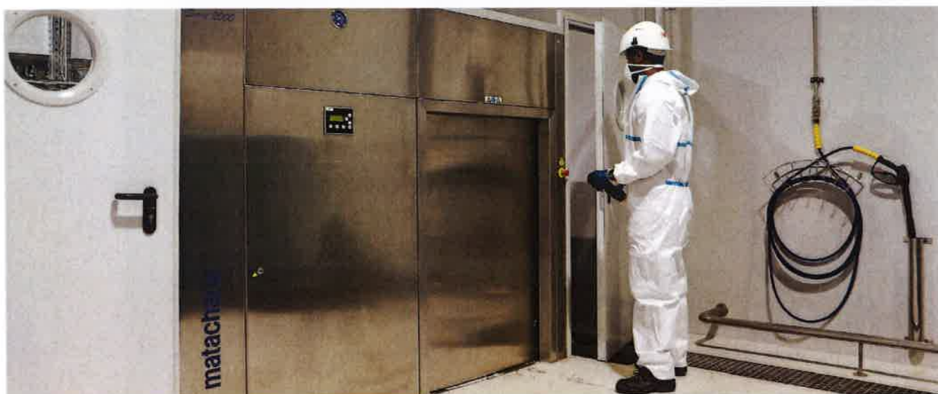
Autoclavagem, ETRS da Meia Serra
