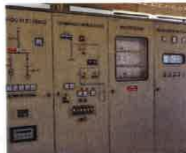
1 Central Hidroelétrica (i.e., mini-hídrica)
